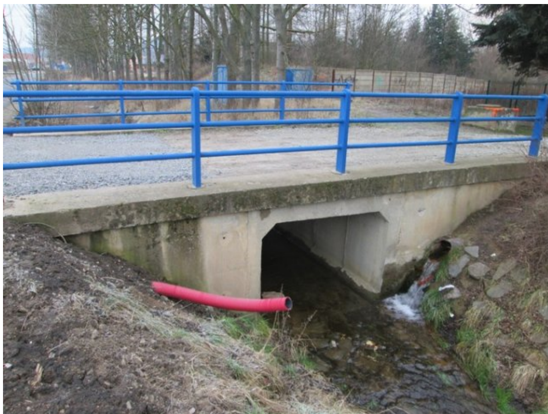
Obr. 4: Propustek u vodárenského zařízení
