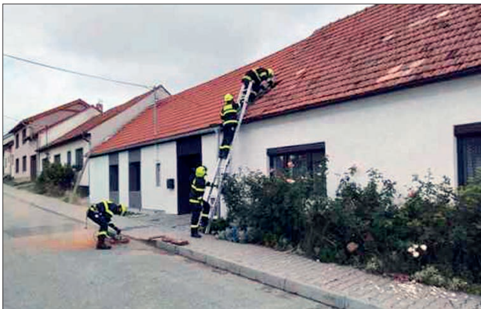
Likvidace následků silného větru v Hodějicích
