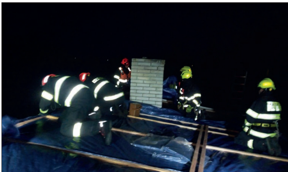
Provizorní oprava odlétnuté střešní konstrukce
