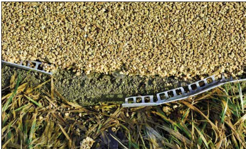
Foto č. 4: Hrubě poškozený kovový lem kolem polyuretanové plochy směrové růžice u rozhledny
